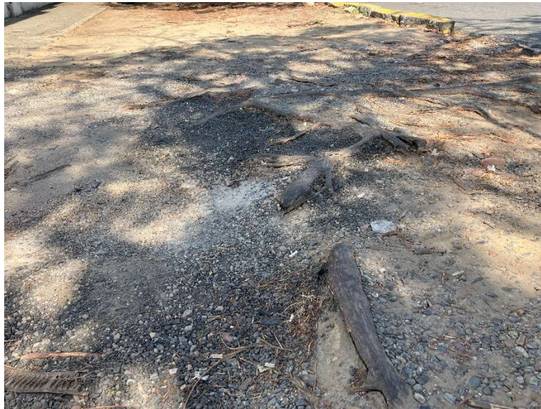
Foto 7 : manutenção da calçada onde se encontra algumas raízes.
