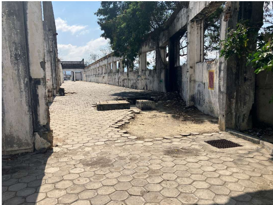
Foto 3 : indicação para reparo nos bloquetes.
