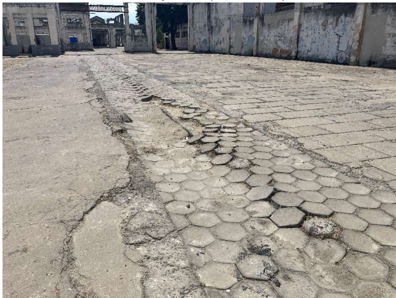
Foto 5 : indicação de reparo em afundamento dos bloquetes.
