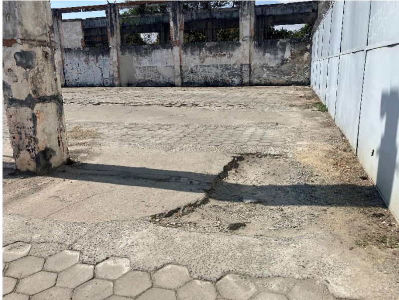
Foto 6 : indicação de reparo nos bloquetes.
